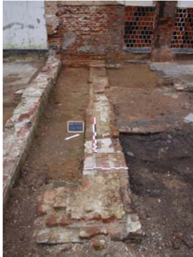
Figuur 16: De toegang S41 is duidelijk later ingebracht in de exterieurmuur S40.
